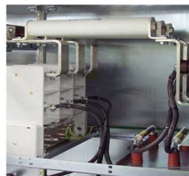
Вид контактора и предохранителей.
