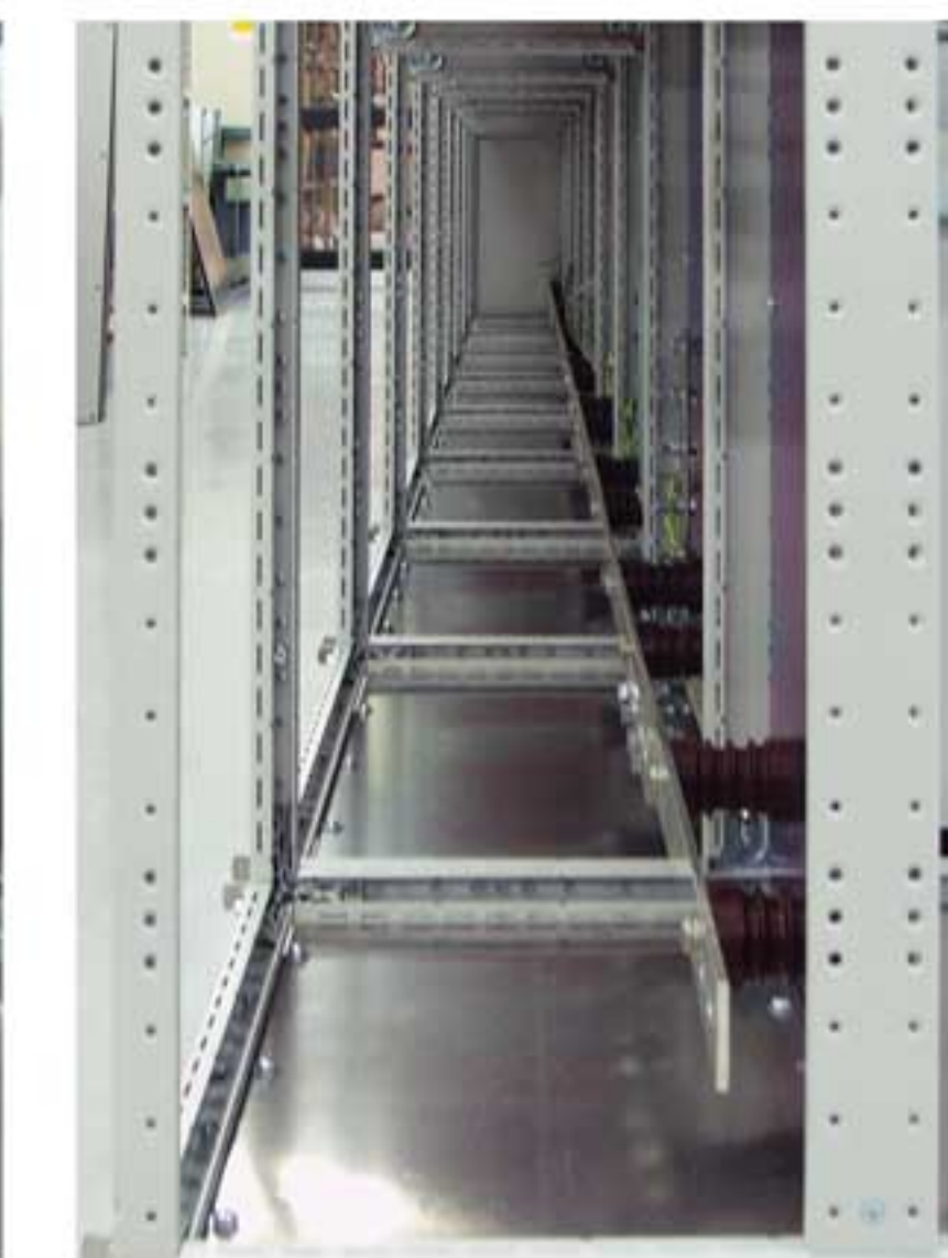
Большое свободное пространство в задней части шкафа упрощает подключение кабелей к УПП. В MVS кабели можно ввести снизу, сверху, слева или справа.
