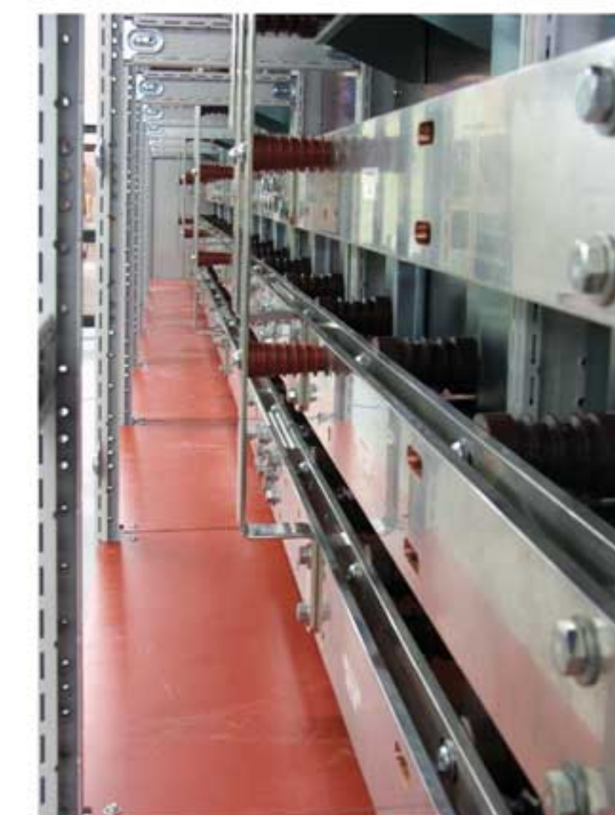
Горизонтальные шины можно проложить по всей длине ваших шкафов. Опционно поставляются изолирующие панели для изоляции входных и выходных шин.
